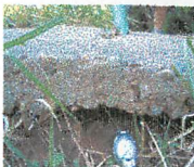
○コンクリートの下の土が削れてしまつて隙間ができています。
